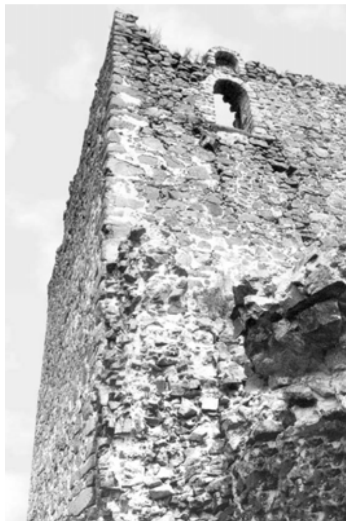
Sl. 24. Glavna kula sa delom obrušenog Severnog bedema, 1975. g.
